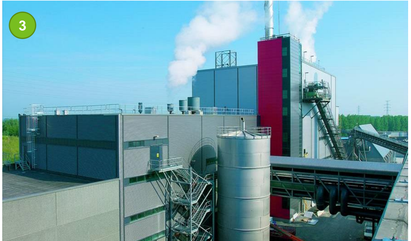
Centrale électrique 1, Langerbrugge Mill
